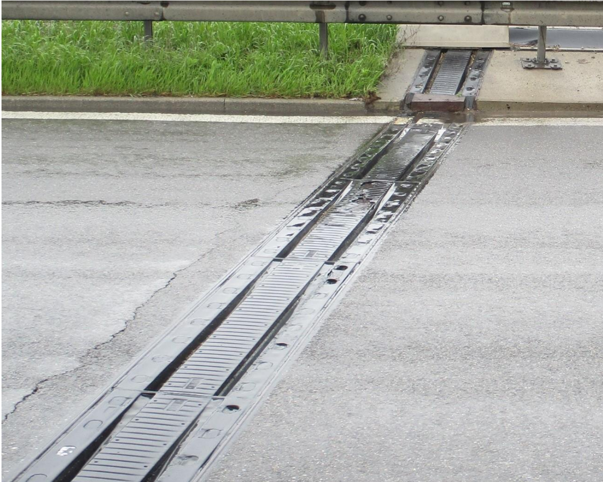
Bild: Schadhafte Übergangskonstruktion, Quelle: Sven Hoppe-RP
